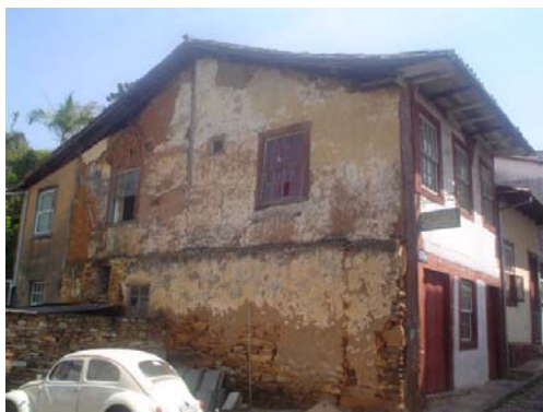
Foto 4: Casa onde dizem ter morado Aleijadinho. Paredes de pau-a-pique sem conservação.
