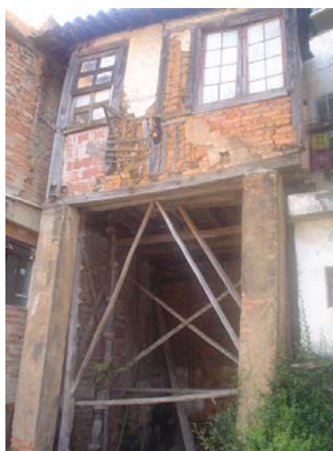
Foto 3: Paredes de pau-a-pique deterioradas e estrutura da edificação comprometida.
