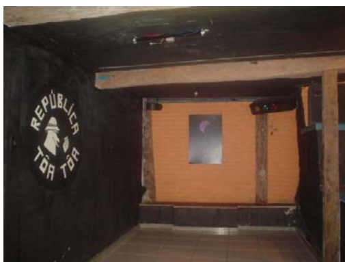
Foto 5 : Espaço do porão improvisado para o funcionamento de uma boate. Instalação elétrica externa o com emendas.
