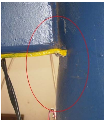
Figura 12 - Esmagamento do pilar pela mesa da viga por forças de compressão.
