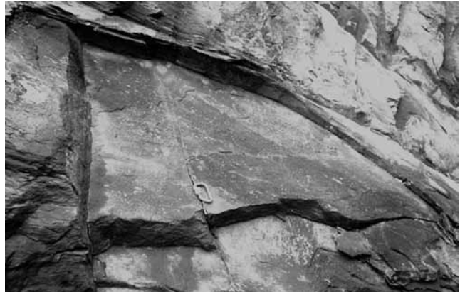
Figura 3 - Bloco rochoso instável na face do Talude Sul.
