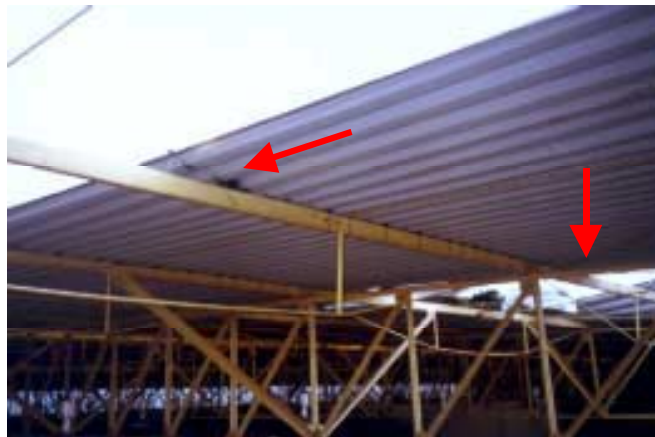
Figura 57 - Falha por insuficiência de parafusos de fixação das telhas sobre as terças
