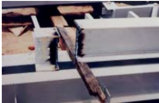
Figura 54 - Erro de projeto: comprimento excessivo – BETINELI 12 , ZACARIAS 55
