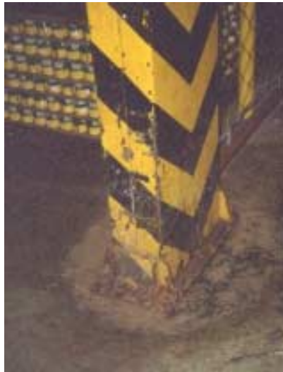
Figura 22 – Base de coluna corroída
