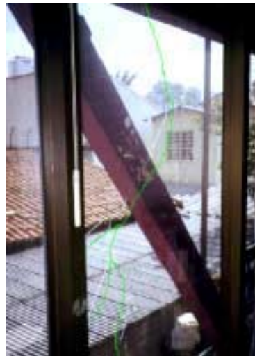
Figura 88 - Trinca em fachada de vidro
