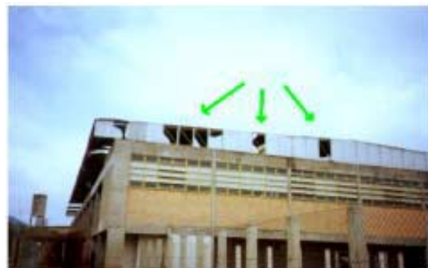
Figura 59 - Falha do fechamento em ponto de alto coeficiente de pressão interna
