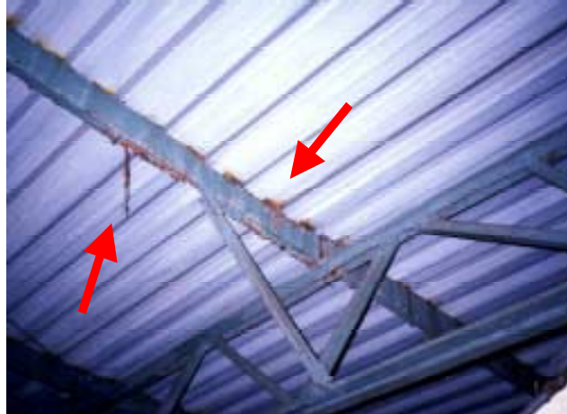
Figura 9 - Terça metálica totalmente corroída
