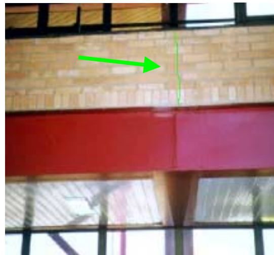
Figura 99 – Fissura na alvenaria sobre o apoio
