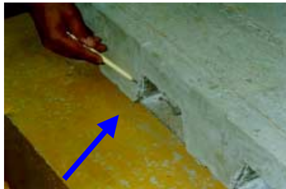
Figura 77 - Descolamento do concreto da chapa de aço – CODEME 18
