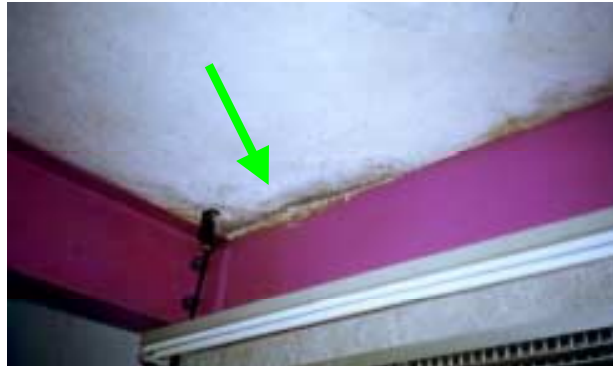
Figura 72 - Corrosão na interface entre laje e viga
