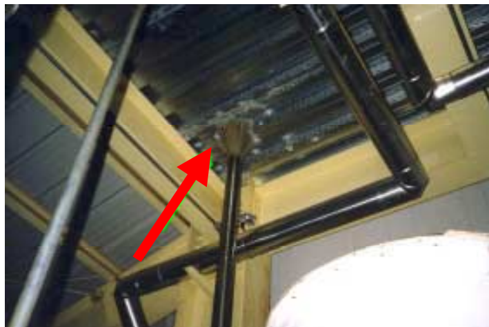
Figura 79 - Diversos pontos de corrosão em uma instalação industrial
