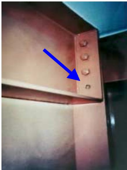
Figura 50 - Falta de furo na coluna – BETINELI 12 , ZACARIAS 55
