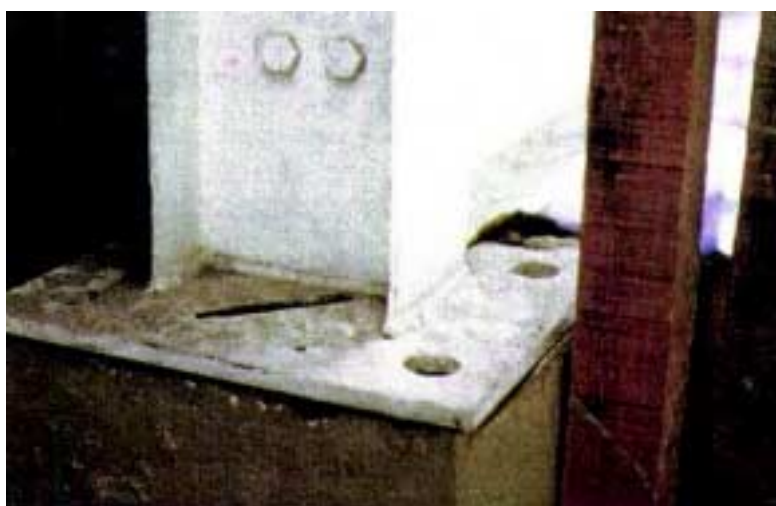
Figura 62 - Base de coluna faltando os chumbadores e com dimensões incorretas do bloco de concreto – SANTOS 62
