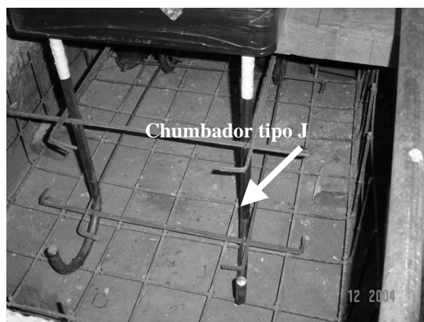
Figura 5.4 – Cava de fundação para a deposição de concreto para a formação da base de assentamento da máquina pendular de impacto Charpy do Laboratório A.
