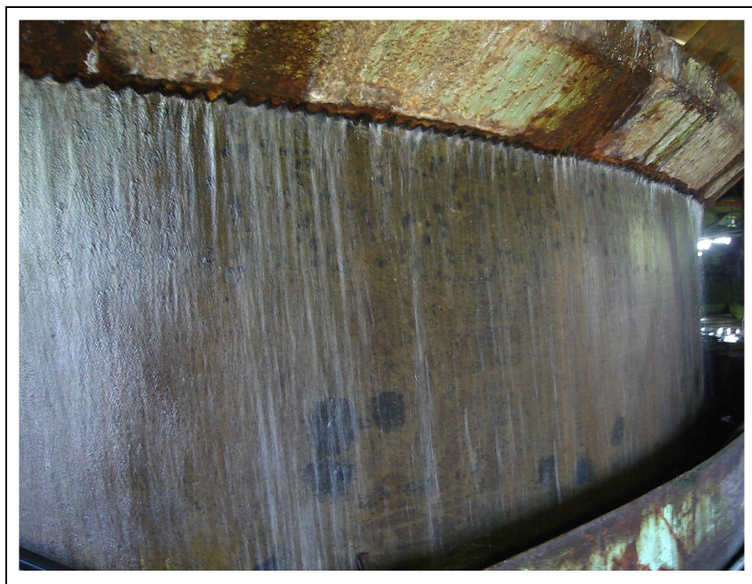
Figura 4.7 – Refrigeração externa do tipo “cortina de água”.
