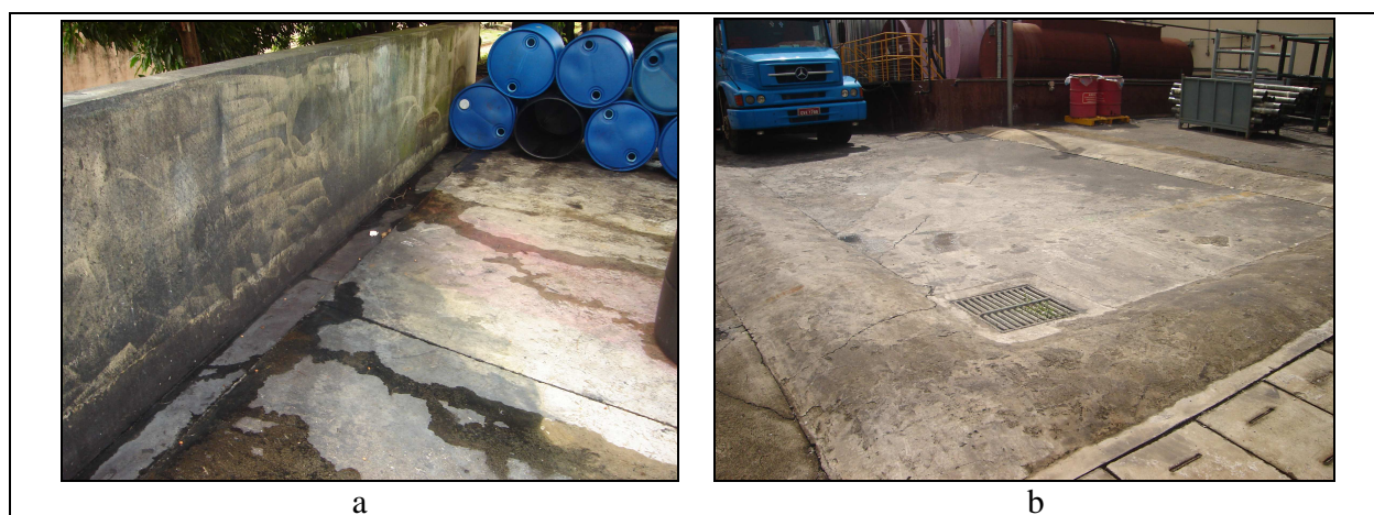
FIGURA 6.3 – Armazenamento de tambores e canaletas para contenção de vazamentos acidentais na empresa X
