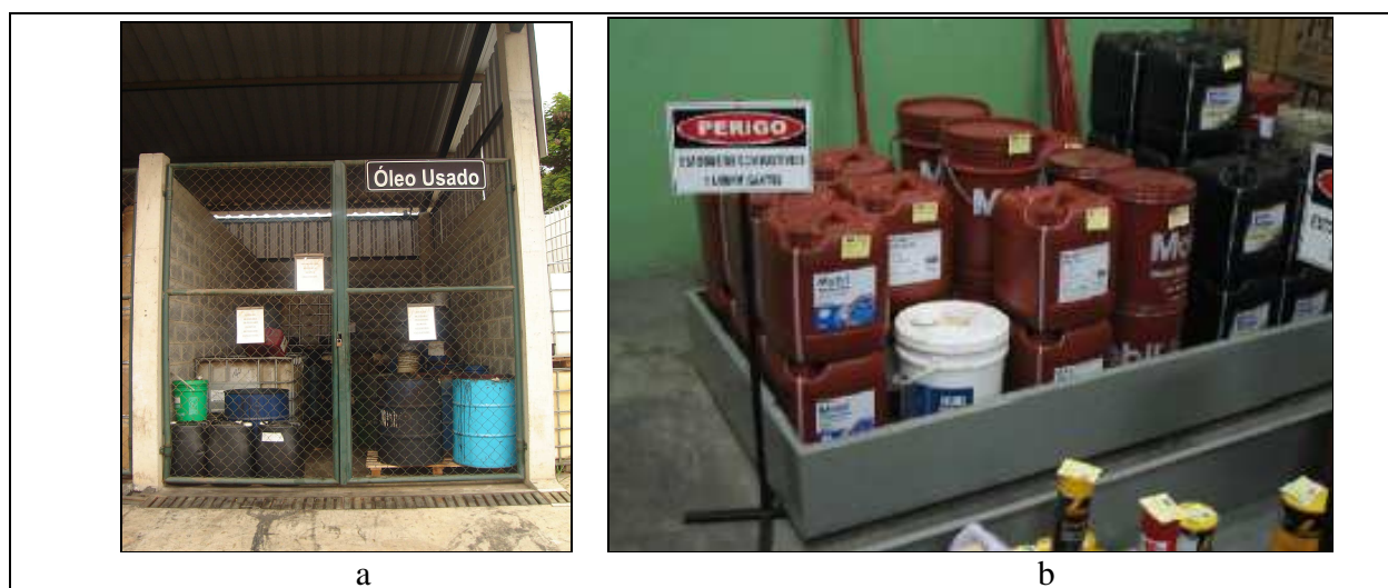
FIGURA 6.5 – Contenção em caso de vazamentos e/ou derramamentos da empresa X
