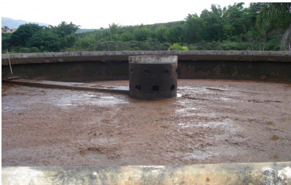
Figura 3.11 Lodo do decantador da ETA Mata do Seminário.
