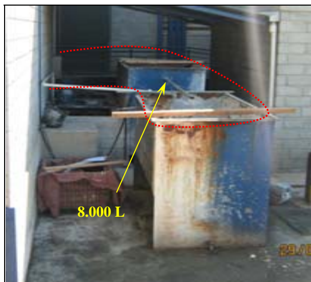
Figura 4.4. Estação de Tratamento de Efluentes Industriais “antes” da implementação da oportunidade de P+L Fonte: Acervo pessoal, imagem obtida em 29 de abril de 2009
