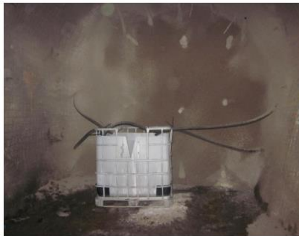
Figura 2: Barricada com drenagem em teste na Mina Raleigh na Austrália.
