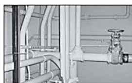
Sistemas de tubulação e encanamentos Fotografia de John M. Cimbala.
