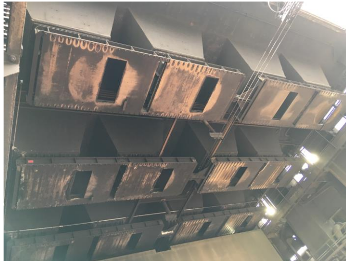
Figura 3.11: Comportas de abertura e fechamento das tremonhas (Gerdau- Usina Ouro Branco)
