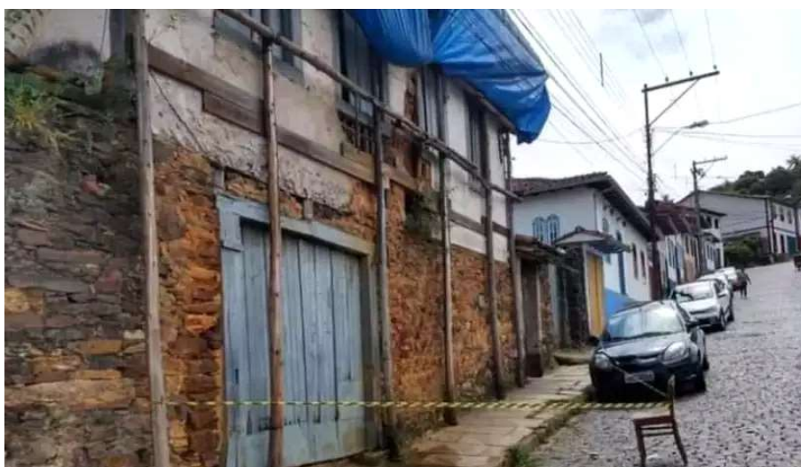
Figura 3 - Casarão do Vira-Saia, após desabamento parcial em janeiro de 2022, bairro de Santa Efigênia, Ouro Preto. Foto: Autor, ano 2022.
