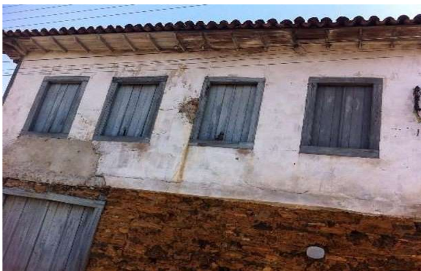
Figura 2 - Casarão do Vira-Saia, antes do desabamento parcial em janeiro de 2022, bairro de Santa Efigênia, Ouro Preto. Foto: Ministério Público, ano 2022
