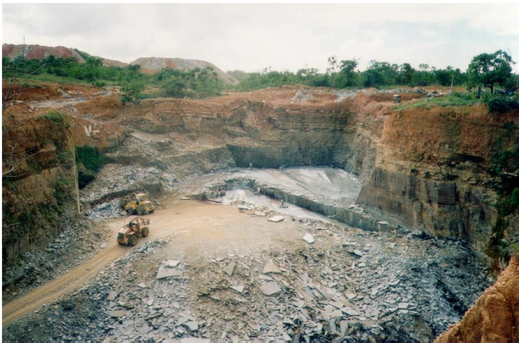
Figura 1.3: Cava, com várias frentes de extração, localizada na margem direita do córrego das Pedras. Ao fundo, pilhas de bota-fora evidenciando a heterogeneidade do material acumulado (Chiodi Filho, et al, 1998)
