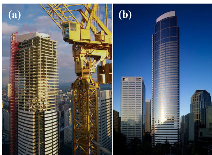
Figura 3.6 – Fotografias do edifício Two Union Square, Seattle, Washington, EUA. (a) construção e (b) edifício totalmente concluído.
