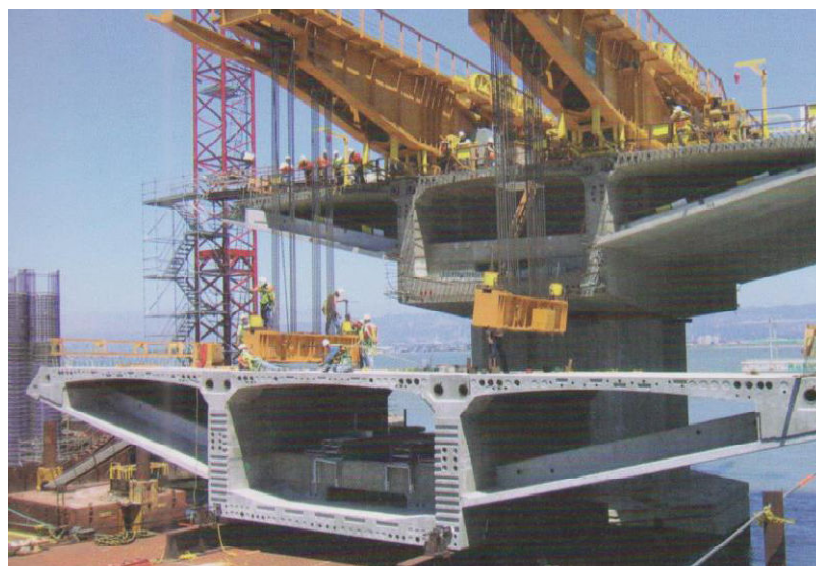
Figura 3.2 – Vigas de concreto pré-moldado sendo instaladas no Skyway Segment, ponte que liga as cidades de Oakland e San Francisco, California, EUA (METHA & MONTEIRO, 2014).
