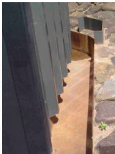
Figura A.7– Detalhe da calha de captação da água que percola pelo fechamento vertical. FONTE: Arquivo pessoal.
