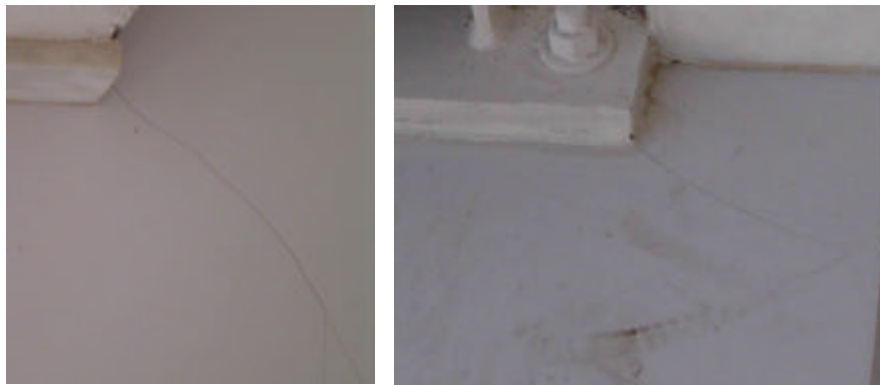
Figura 4.45 –Cerâmicas de piso trincadas. FONTE: Arquivo pessoal.
