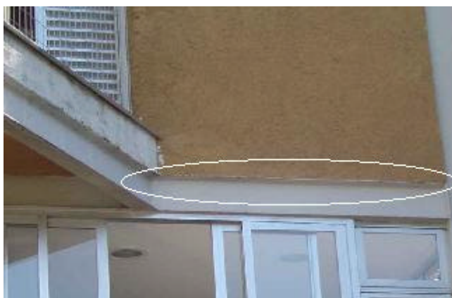
Figura 4.24 – Estrutura avançando no alinhamento em relação à linha da alvenaria: ponto de acúmulo de umidade. FONTE: Arquivo pessoal
