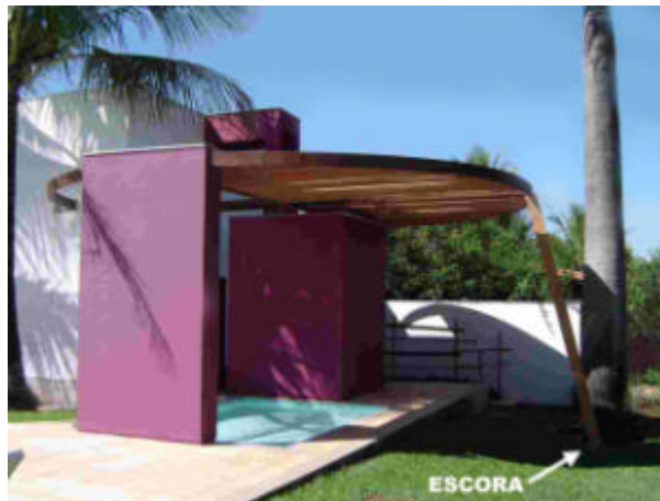
Figura 4.64 - Estrutura da pérgola tendo de ser escorada. FONTE: Arquivo pessoal.
