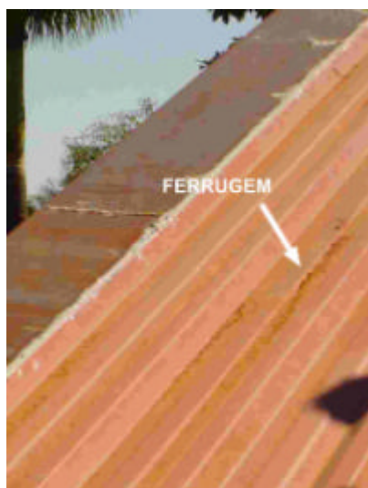
Figura 4.63 – Limalha corroída aderida à superfície da telha metálica. FONTE: Arquivo pessoal.
