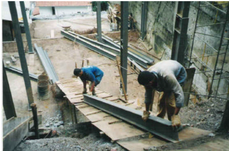
Figura 4.41 – Desembarque manual da estrutura pela rampa de acesso. FONTE: Arquivo do arquiteto.
