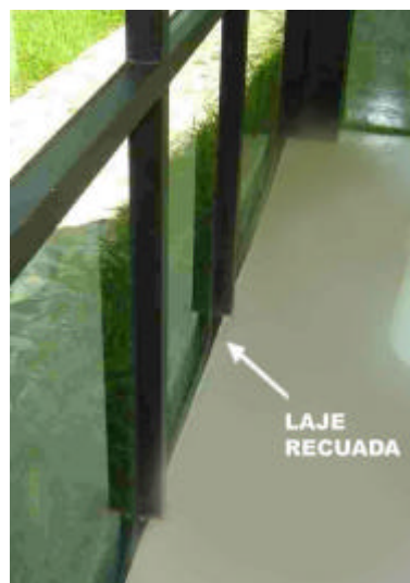
Figura 4.58– Detalhe da pele de vidro e do recuo da laje. FONTE: Arquivo pessoal.
