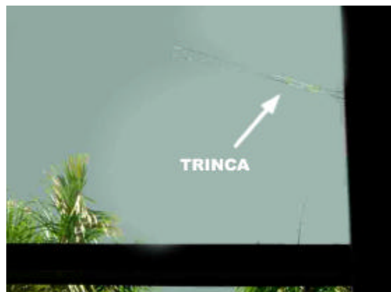
Figura 4.62 – Chapa de vidro trincada. FONTE: Arquivo pessoal.
