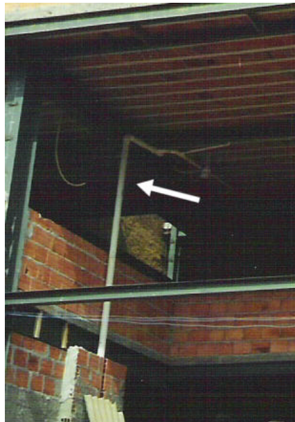
Figura 4.39 – Interferência tubulação hidráulica: tubo de queda do banheiro central aparente. FONTE: Arquivo do arquiteto.
