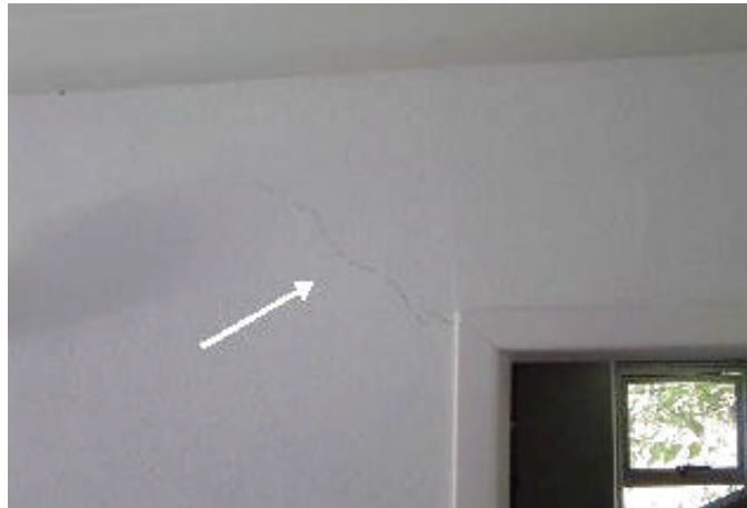
Figura 4.18 – Trinca possivelmente relacionada à falta de junta de expansão entre a viga metálica e a alvenaria.
