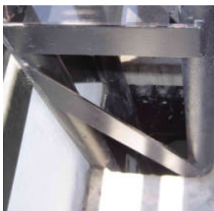
Figura A.8– Detalhe da laje de piso desconectada do fechamento vertical. FONTE: Arquivo pessoal.
