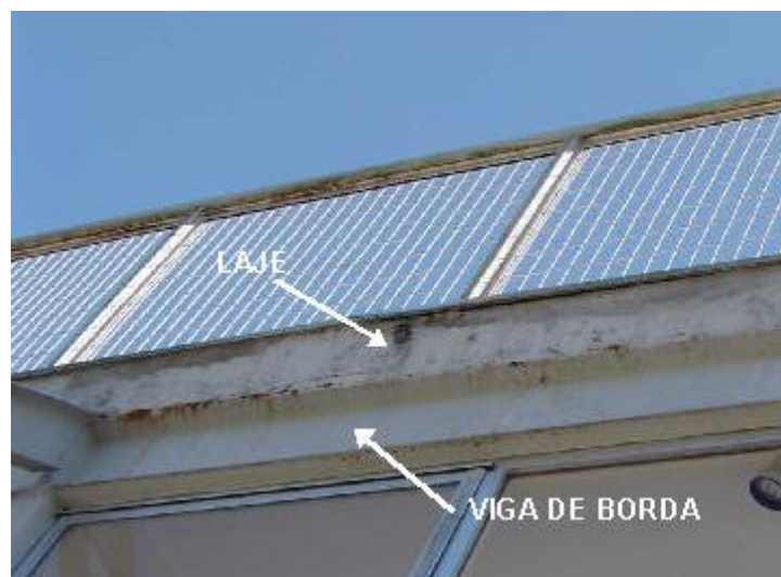
Figura 4.27 – Detalhe comprometimento da viga de borda da laje do terraço. FONTE: Arquivo pessoal
