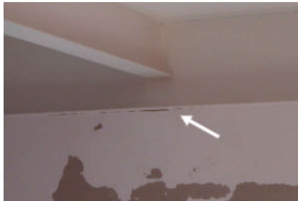
Figura 4.42 – Fissura entre viga e alvenaria, e recomposição de pintura. FONTE: Arquivo pessoal.
