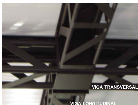
Figura A.4– Diferenças de bitolas dos tubos das vigas transversal e longitudinal. FONTE: Arquivo pessoal.
