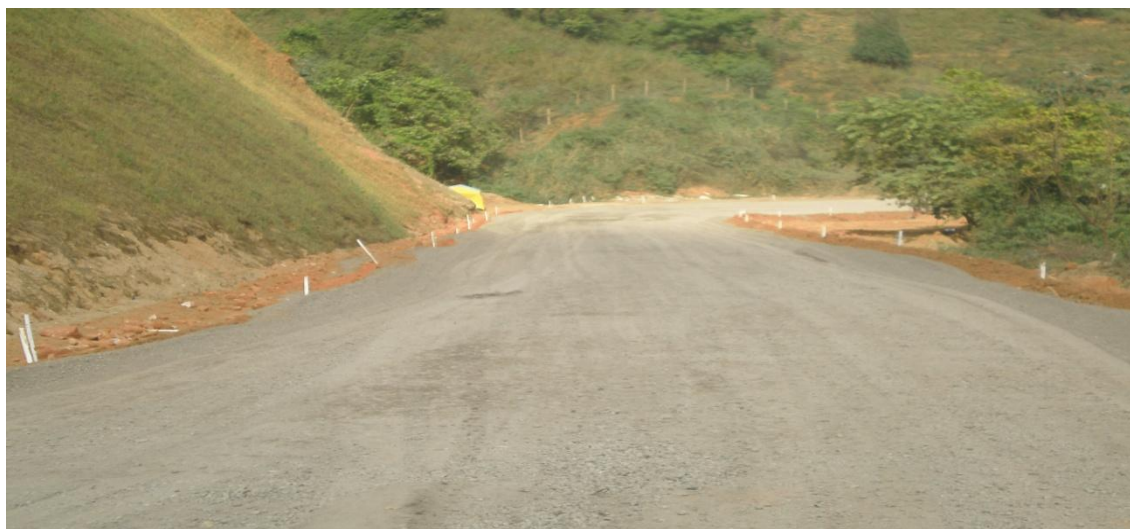
Figura 1.2 - Base de escória + 20% de argila em execução - MG-232 - Trecho: Mesquita - Santana do Paraíso - estaca 424 (ACERVO TÉCNICO 40ª CRG - DER/MG, 2007).
