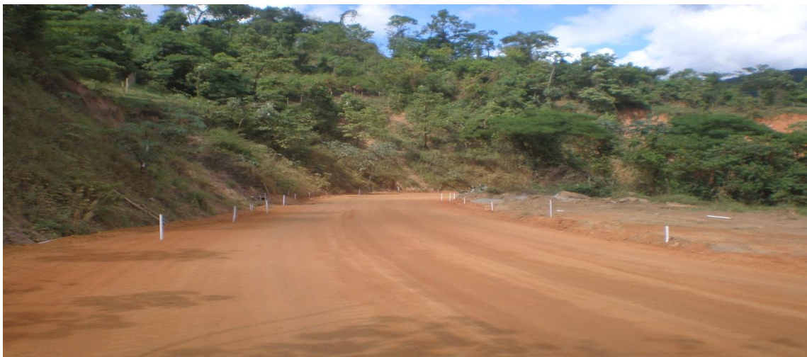
Figura 4.20 - Subleito da MG-232 - Trecho: Mesquita - Santana do Paraíso - Estaca 424 (ACERVO TÉCNICO 40ª CRG - DER/MG, 2007).
