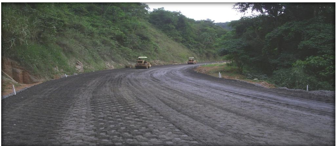
Figura 2.41– Confecção da camada de base de um pavimento rodoviário, executada em escória de aciaria LD (ACERVO DO DER/MG-40ª CRG, 2006).
