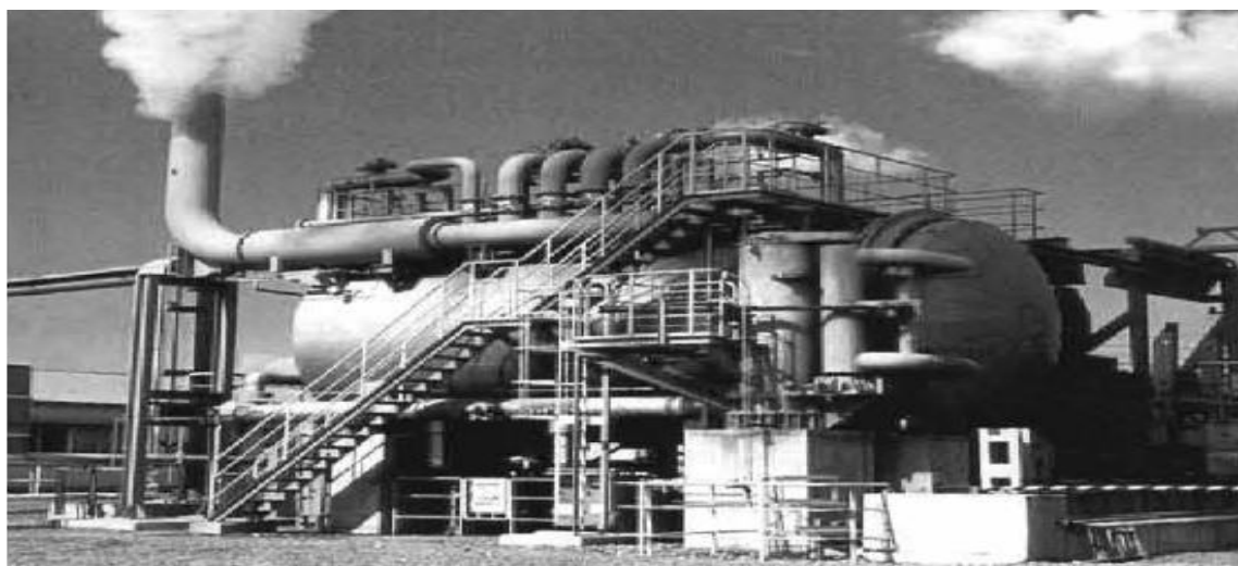
Figura 2.32 - Autoclave para cura da escória de aciaria com vapor d'água no Japão (ABM, 2004).
