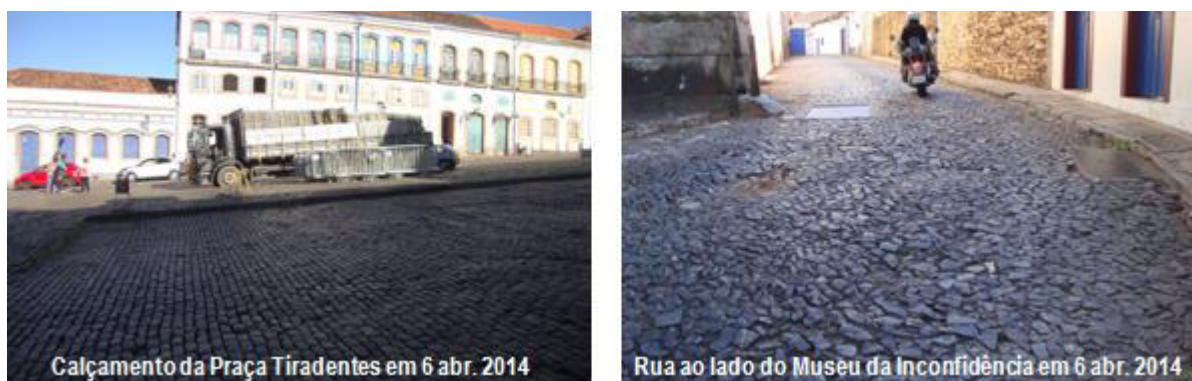
Figura 5: Calçamento danificado em vias do centro histórico
