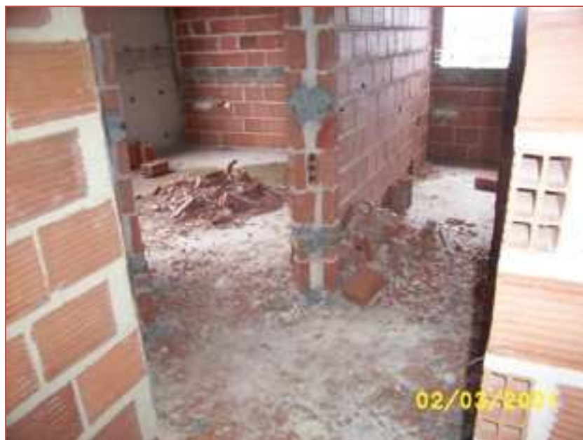
Figura 6 – Desperdício de material – resíduos de alvenaria Fonte: PINTO, GONZALEZ, 2005
