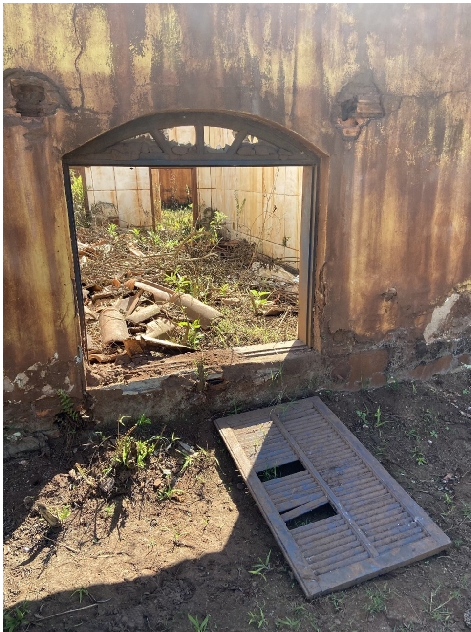
Imagem 25 - Ruínas em Paracatu de Baixo, 29 de julho de 2022
