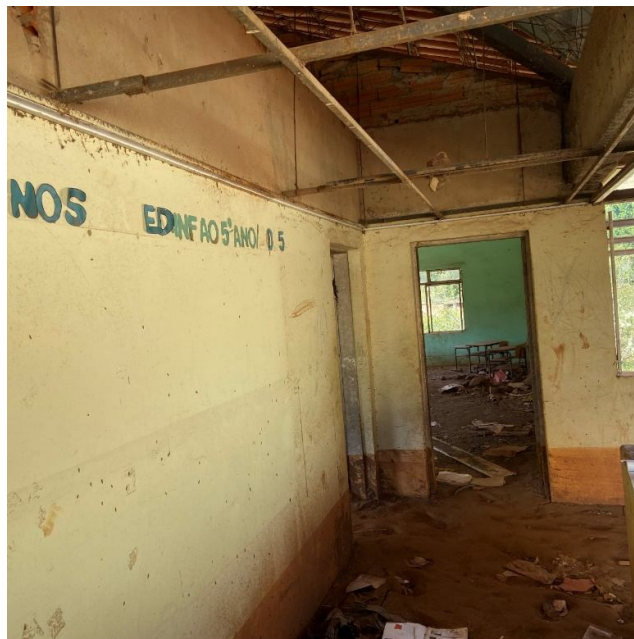
Imagem 35 - Ruínas da Escola Municipal em Paracatu de Baixo, 29 de julho de 2022
